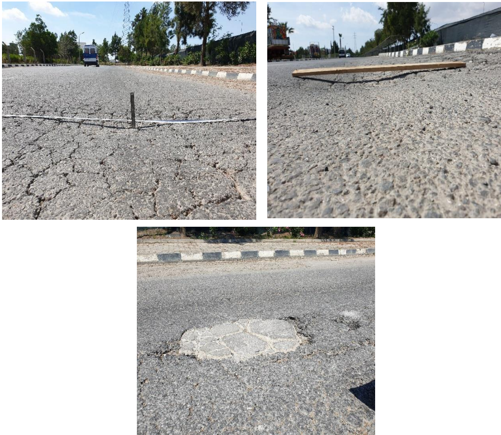
شکل ۶: قسمتی از خرابی های موجود در محوطه دانشگاه مدیترانه شرقی
